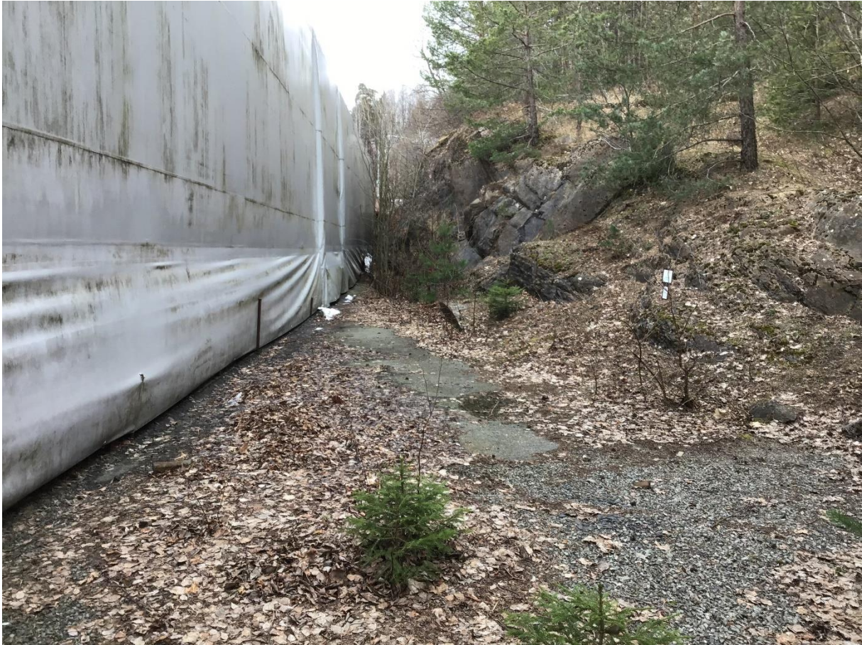
Figur 5: Kileformet asfaltert platting bak plasthallens østre del. Merk skilt om naturreservat i midtre-høyre del av bildet.
