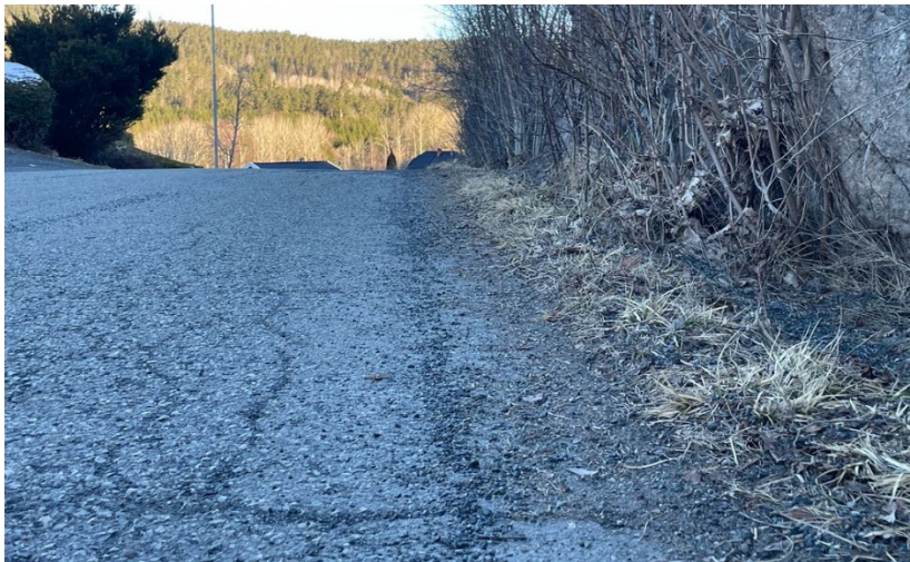
Figur 13 Manglende grøft, med konsekvens at vannet blir værende på veien. Foto: Roy Rikardsen
