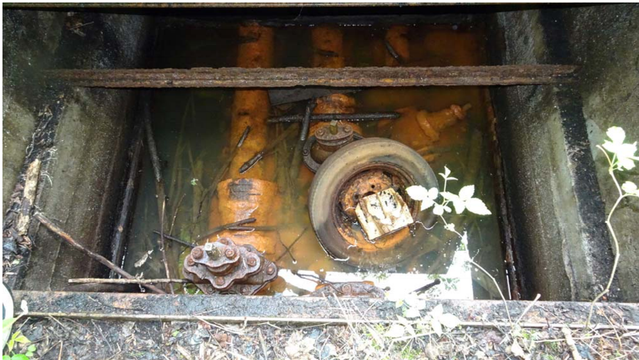
Figur 2-6: Rørsystem i kum ved damfoten. Bildet er tatt fra damfot og mot nedstrøms side. Foto: Elin Hønsi (VTA)
