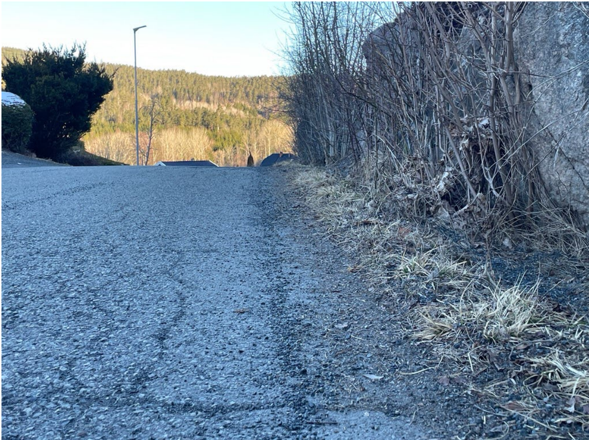
Figur 9 Det er lagt seg en kant av strøgrus og gress, som hindrer vannet å renne ut. Asfalten degraderes. Foto: Roy Rikardsen
