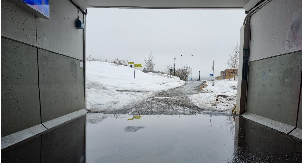
Figur 15 Vann i kulvert. Bidrar til mindre attraktive gangveier og kan være ufremkommelig for noen. Foto: Mari Gabrielsen
