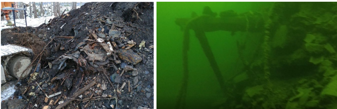
Figur 37(til venstre) Haug av utgravd materiale rett ved eiendomsgrensen til Tåjeodden. Sand, alunskifer, sement, teglstein, jernskrap, trevirke, tjærepapp, osv. Figur 38(til høyre) Stålstruktur med kabler som stikker ut fra skråningen under vann.
