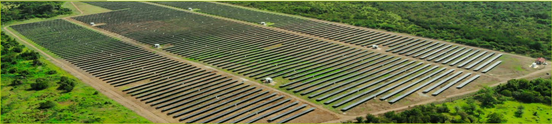
Planta fotovoltaica Llanos del sur (Honduras)
