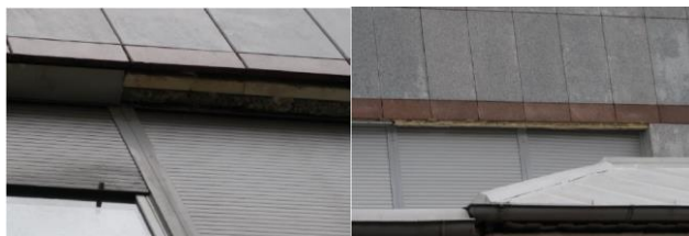
Sl.3.1.2) Oštećenja na fasadi iznad prozora
